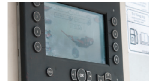
Sistema de control por PLC con pantalla a color de fácil utilización
